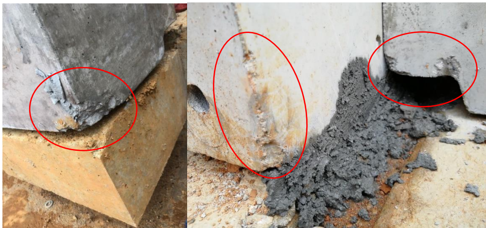
照片 1 PC 柱柱根缺棱掉角
